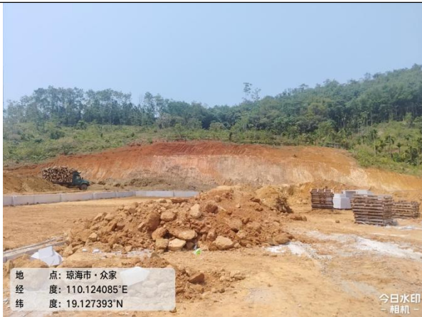
裸露边坡现状
