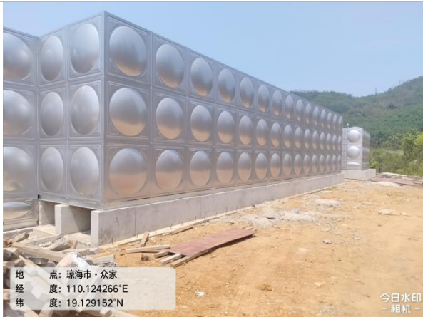
一体化给水泵房现状
